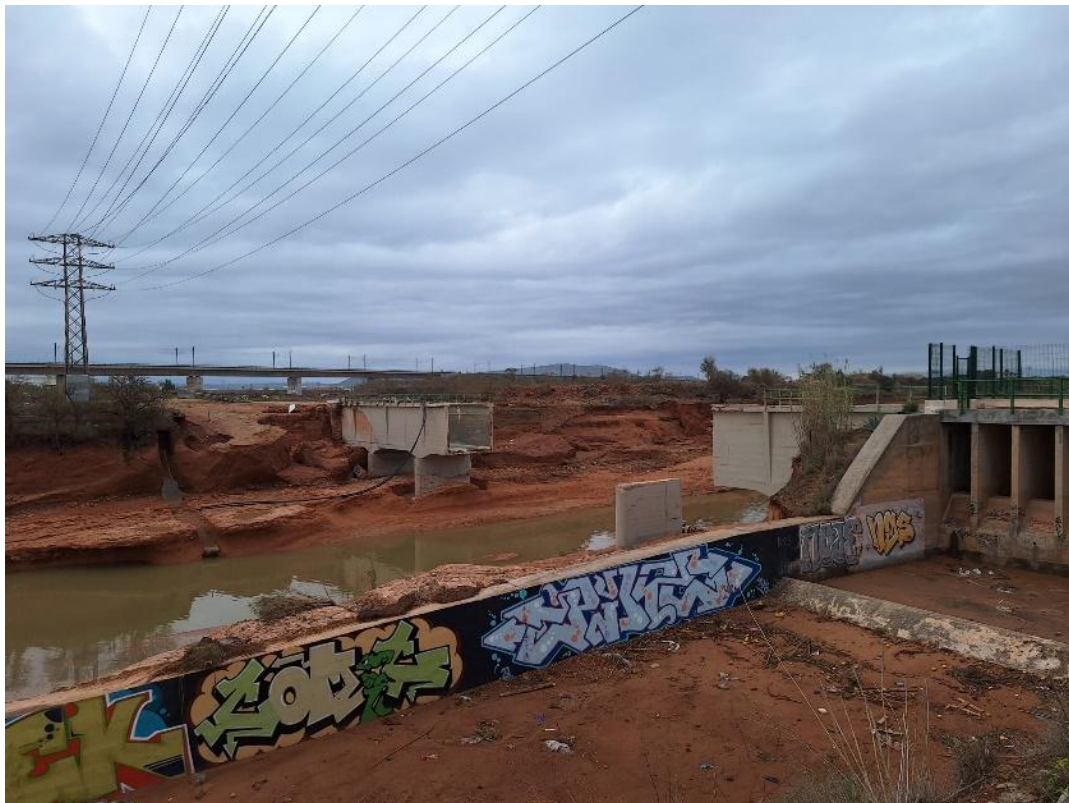
Rotura del acueducto del Poyo
