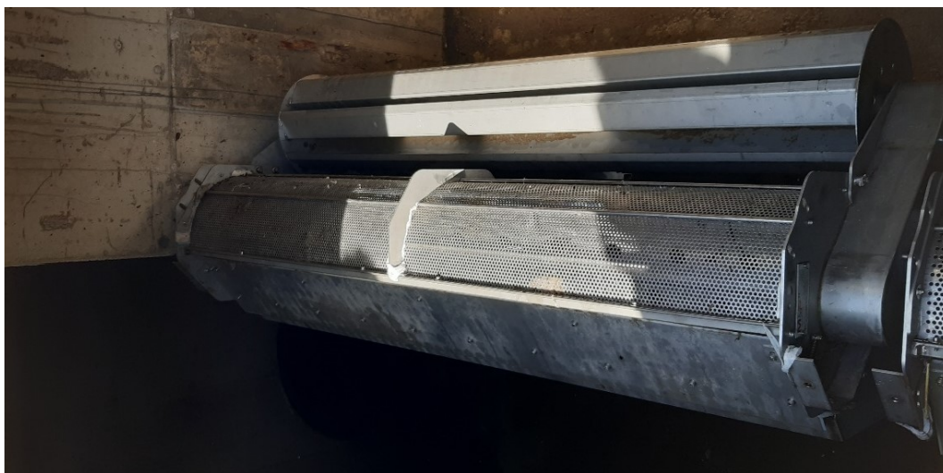
Tamiz en punto de desbordamiento perteneciente al sistema de saneamiento.
