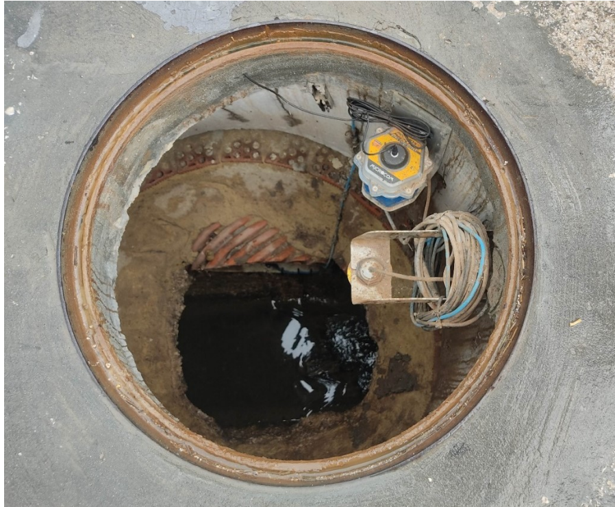
Sonda de detección del número de episodios de lluvia y limnómetro en colector de red de saneamiento
